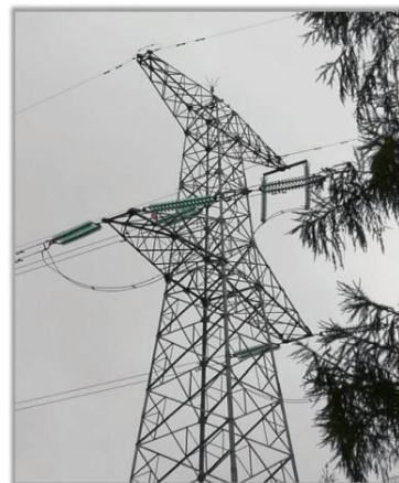
高压输电线路安装防雷设备实景图
